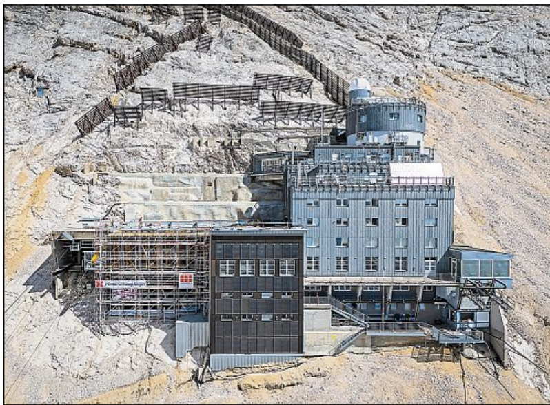
Die höchste Baustelle Deutschlands befindet sich derzeit auf dem Schneefernerhaus, rund 300 Meter unter dem Gipfel der Zugspitze.
