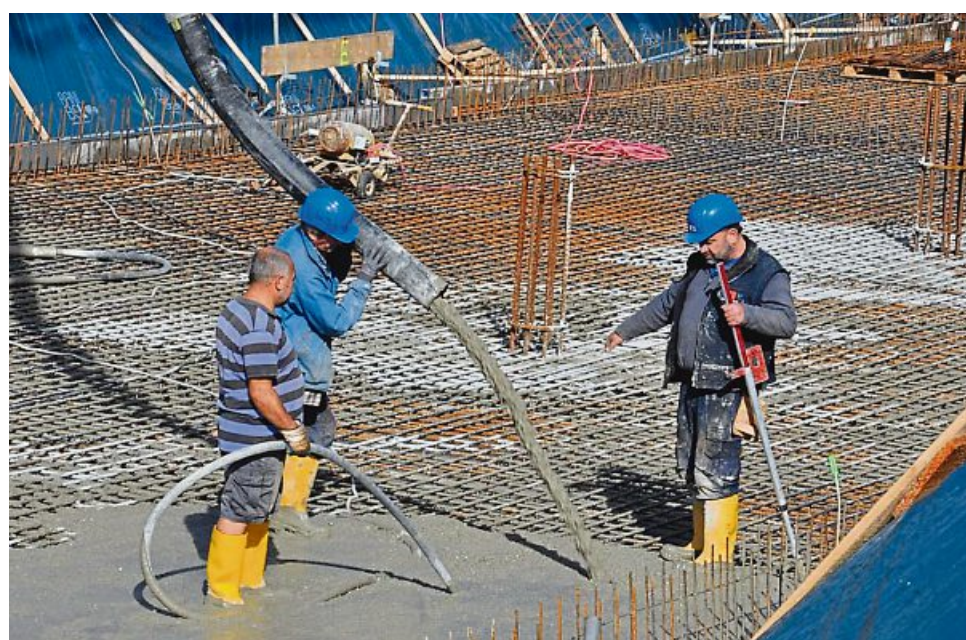
In Aktion: Diese Arbeiter betonieren am Dienstagvormittag die Bodenplatte des neuen Zugspitzbahnhofs.
